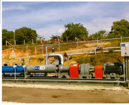
Multiphase Pumping (MPP)
